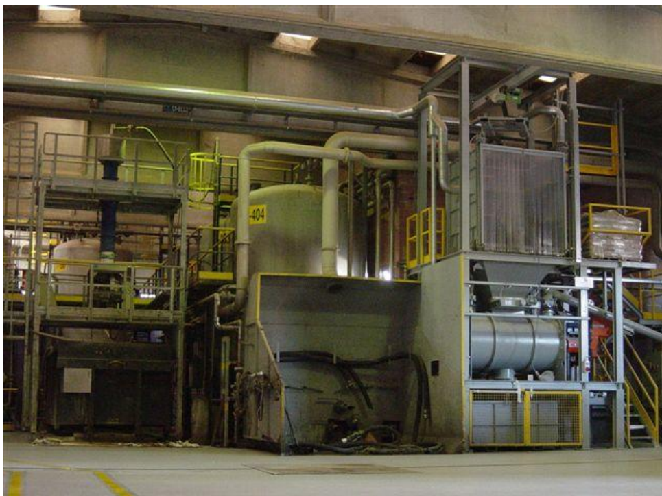
Figura 7 – Vista d'insieme dell'impianto di trattamento chimico-fisico
