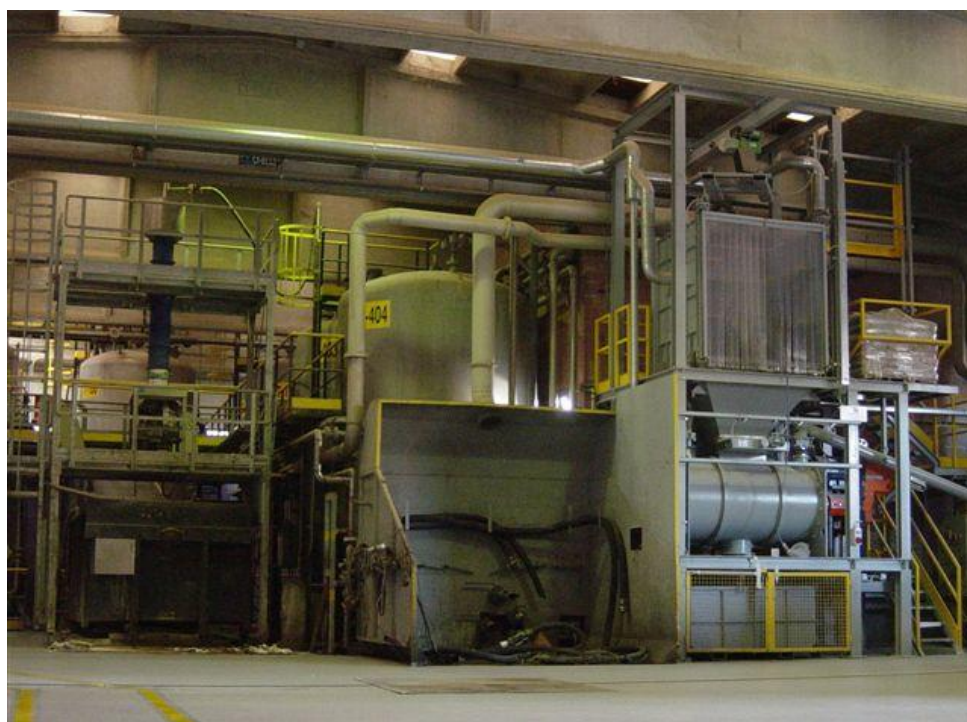
Figura 7 – Vista d'insieme dell'impianto di trattamento chimico-fisico
