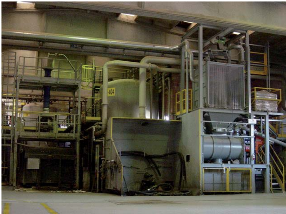
Figura 7 – Vista d'insieme dell'impianto di trattamento chimico-fisico
